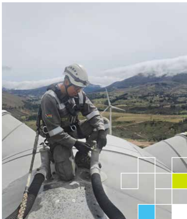
Purgado del sistema de refrigeración de agua en el aerogenerador, tras detectar la presencia de aire en el sistema – Parque Eólico Qollpana
