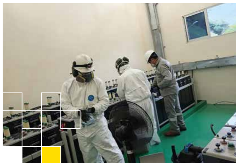
Mantenimiento de banco de baterías de la Central Hidroeléctrica San José 2
