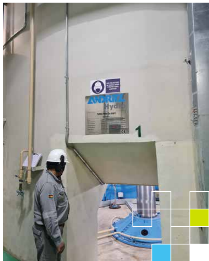
Inspección al generador de la Central Hidroeléctrica San José 2
