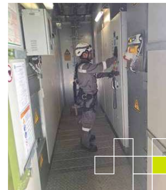
Revisión de cubicales de la Central Eólica Qollpana
