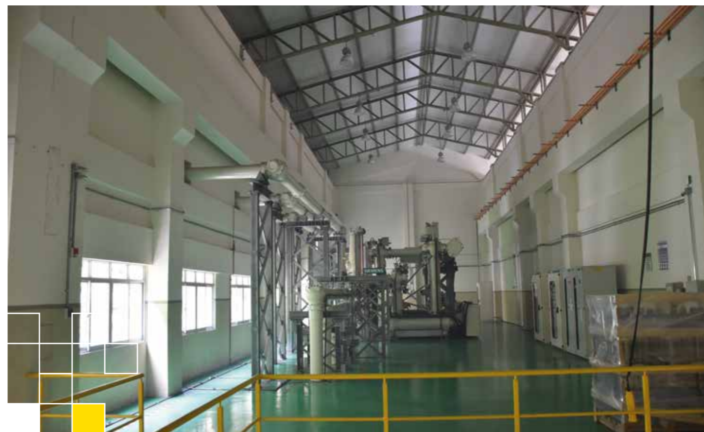
Subestación GIS de la Central Hidroeléctrica San José 2
