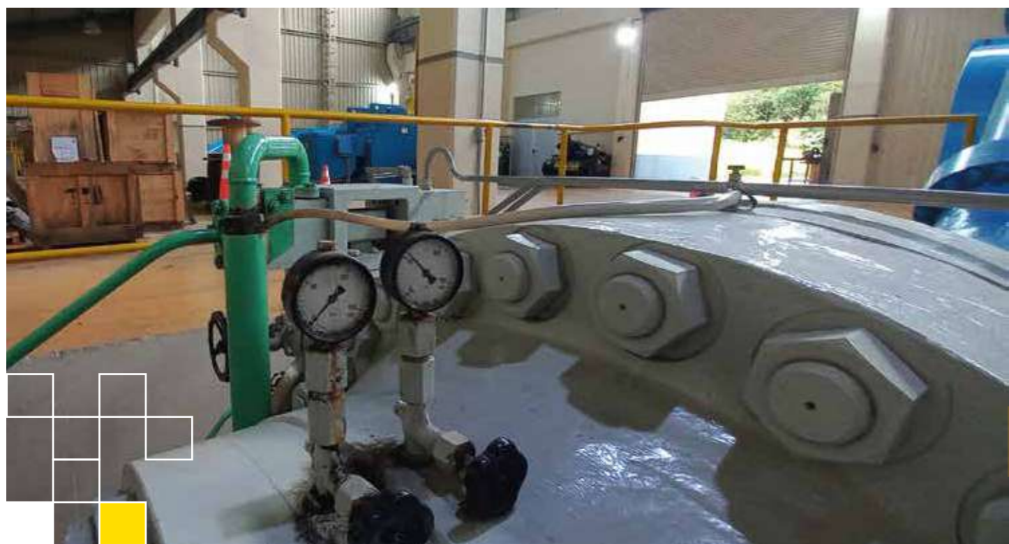
Revisión y control de manómetros de la Central Hidroeléctrica Corani
