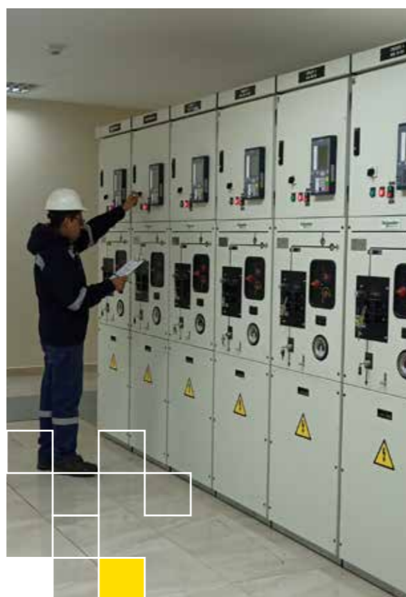
Inspección de equipos de subestación en el PE Qollpana
