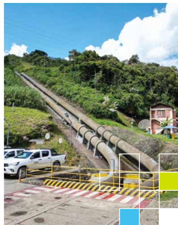
Tubería Penstock de la Central Hidroeléctrica Santa Isabel
