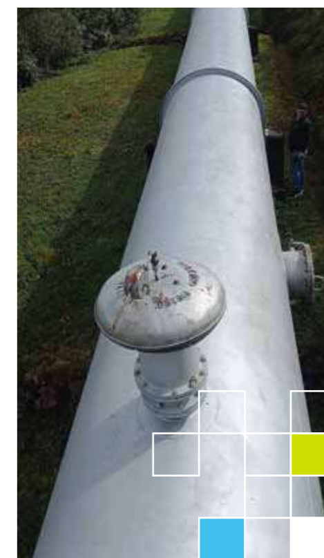
Evaluación a sistemas de control de la aducción de la Central Hidroeléctrica Corani
